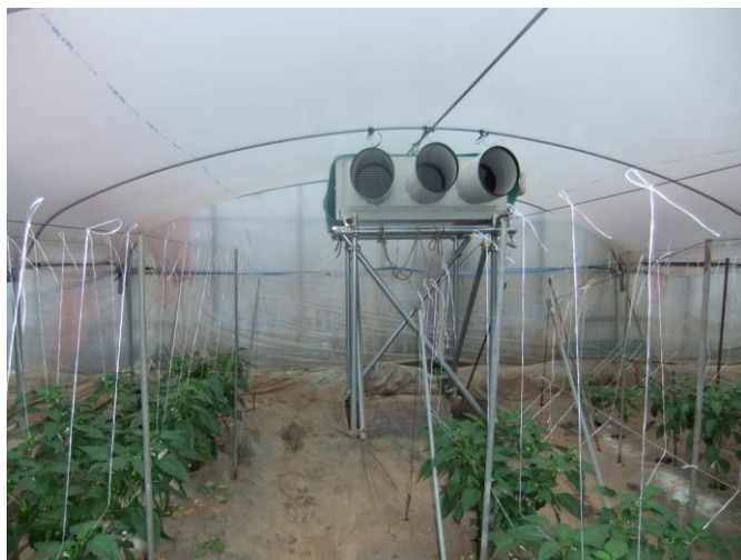
加温はヒートポンプ主体で一定の温湿度で病害抑制
